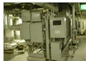
冷温水発生機
