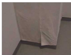
仕上げ材の剥がれ
