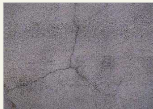
モルタルのひび割れ
