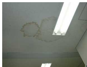
漏水による染み
