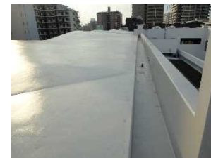
屋根・屋上防水に損傷や浮きはありませんか？
