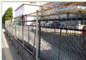
フェンスのさび
