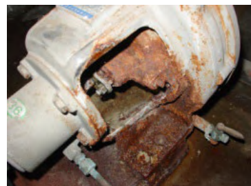
ポンプの腐食
