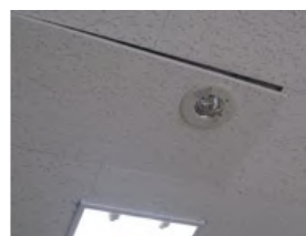
天井ボードの剥れ❖ 1
