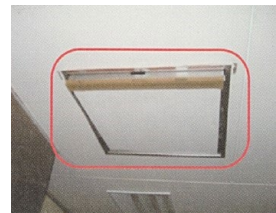
点検口の開閉不良❖ 2
