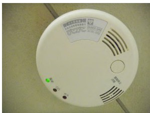
ガス漏れ警報器
