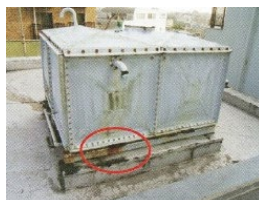
受水槽の漏水❖5
