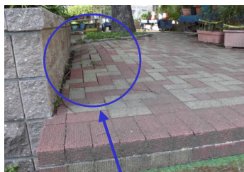
舗装の不陸や傾斜
