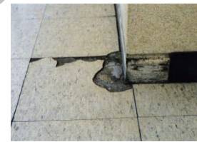
床仕上げ材の剥がれ
