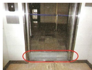
エレベーター扉の段差※12
