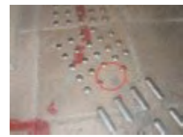
誘導鉄の欠損❖ 4
