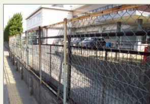
フェンスのさび
