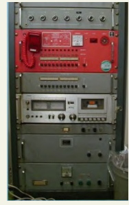
非常放送用アンプ
