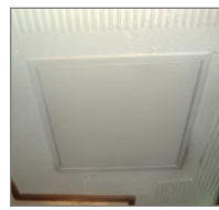
排煙口（通常閉鎖）
