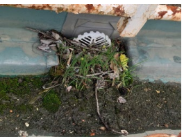
ルーフドレンの清掃不良
