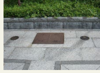
水道メーターボックス (親メーター)
