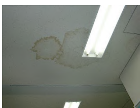
漏水による染み
