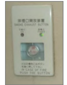
排煙口開放装置
