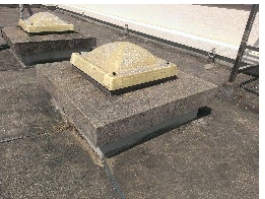
経年劣化したトップライト
