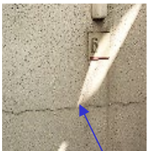
仕上げ材のひび割れ
