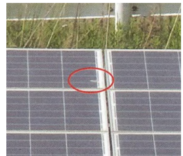
太陽光パネルの損傷❖9
