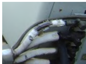
配管断熱材の剥れ
