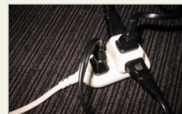
電気器具のつなぎすぎ
