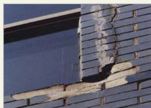
タイルの浮き・割れ
