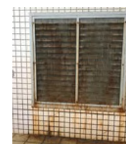
吸入口の腐食
