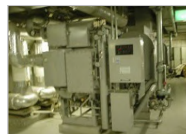
冷温水発生機
