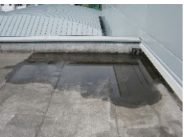
不陸による水溜まり
