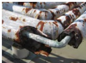
配管断熱材の損傷
