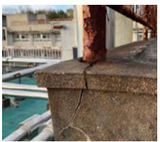
支柱部付近の損傷
