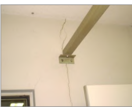
壁のひび割れ
