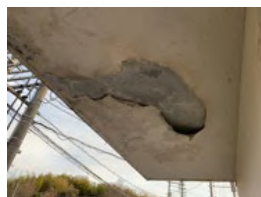
庇部の仕上げ材の剥れ
