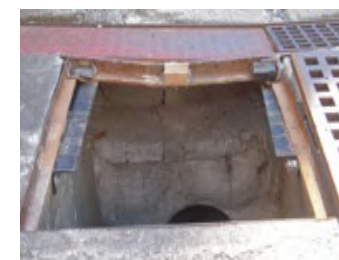
枠の損傷（蓋の浮きの原因）
