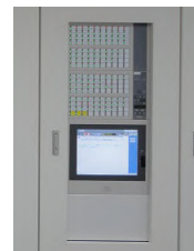
中央監視装置
