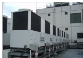
個別空調室外機
