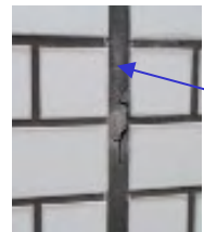
目地ひび割れ
