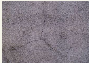
モルタルのひび割れ
